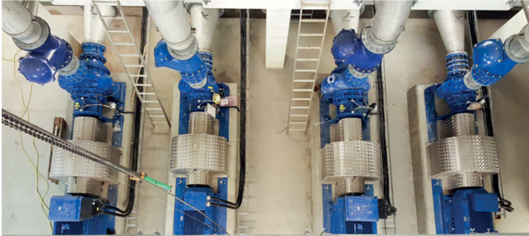
De fire Hidrostat-pumpene i drift. 2 stk. 110K-H02RS (430 l/s mot 37 m) og 2 stk. H08G-SMN2R (300l/s mot 37 m).
