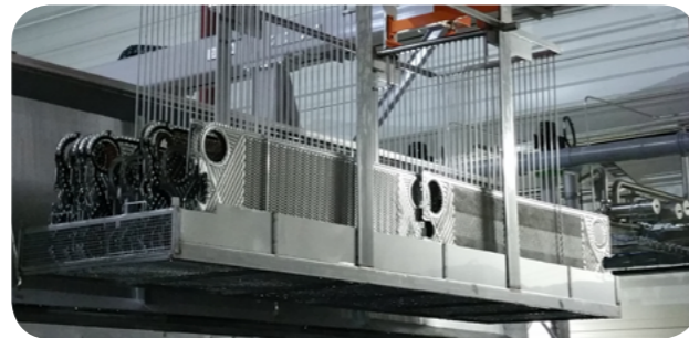
Ligne de dégraissage /détartrage robotisée
